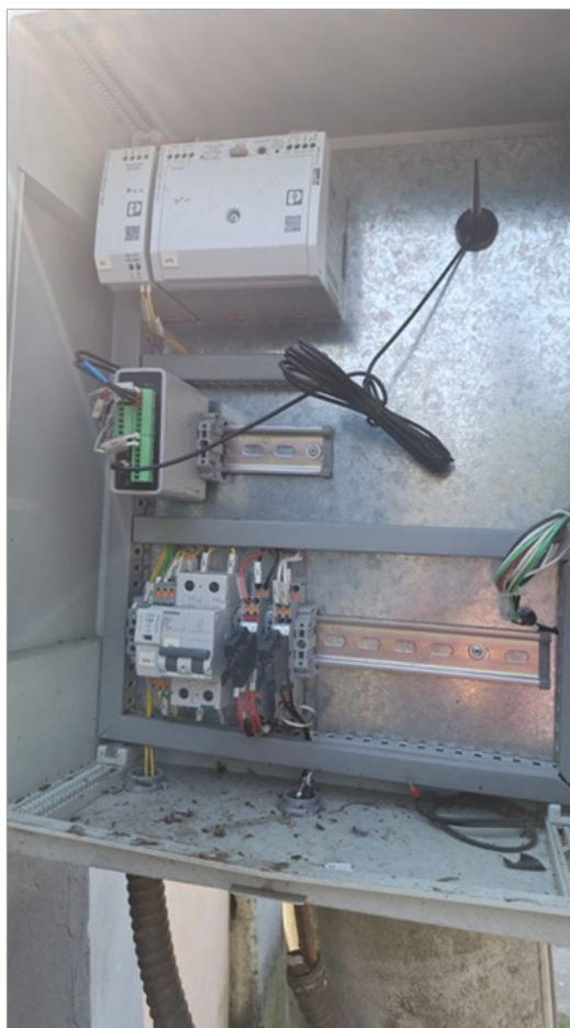
Foto 7 - Vista do interior do painel de telemetria.
