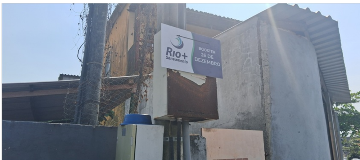
Foto 2 - Placa de identificação e painel elétrico. Destaca-se a corrosão avançada na estrutura do painel.
