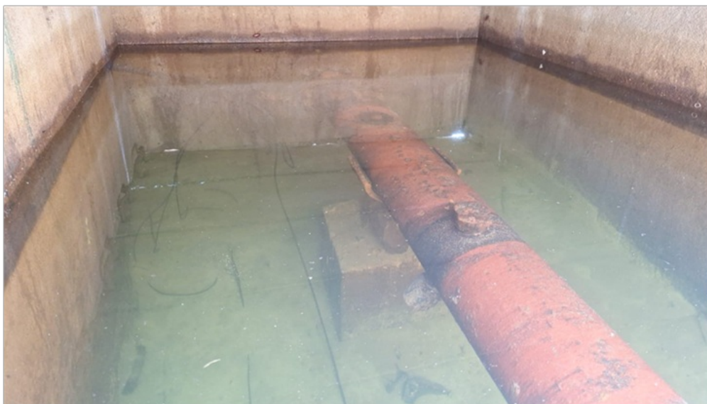
Foto 4 - Tubulação de sucção de recalque. Nota-se grande quantidade de água pluvial armazenada no poço da bomba.
