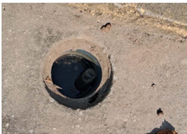
Foto 5 – Interior do registro de recalque que estava com água acumulada e resíduo.
